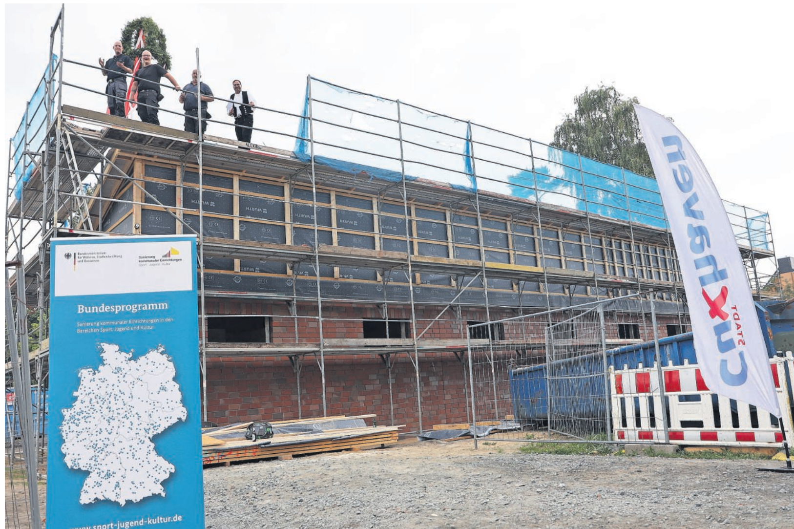
Am Dienstagabend wurde das Richtfest des neuen Umkleidegebäudes auf dem Grodener Sportplatz gefeiert. Im Frühjahr 2024 sollen die 230 Quadratmeter großen Räumlichkeiten nutzbar sein. Foto: Unruh
