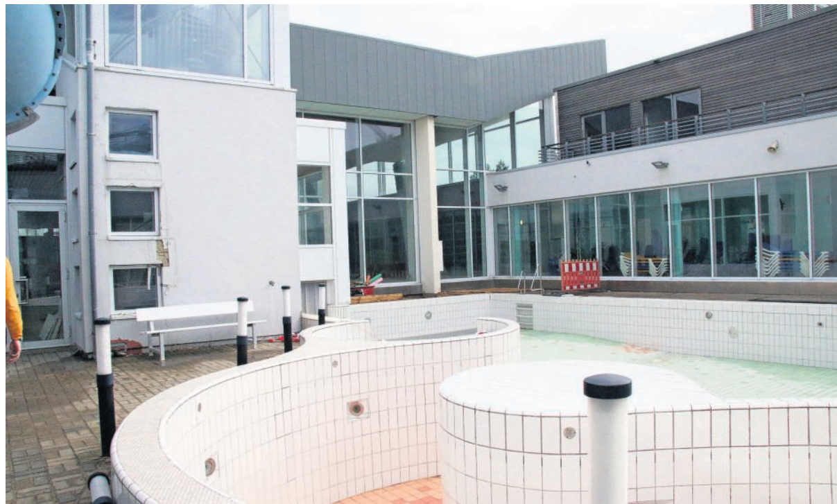
Auch im Bereich des Außenbeckens sind Fliesenleger dabei, letzte Arbeiten zu erledigen, bevor das Becken wieder mit Meerwasser befüllt wird.
