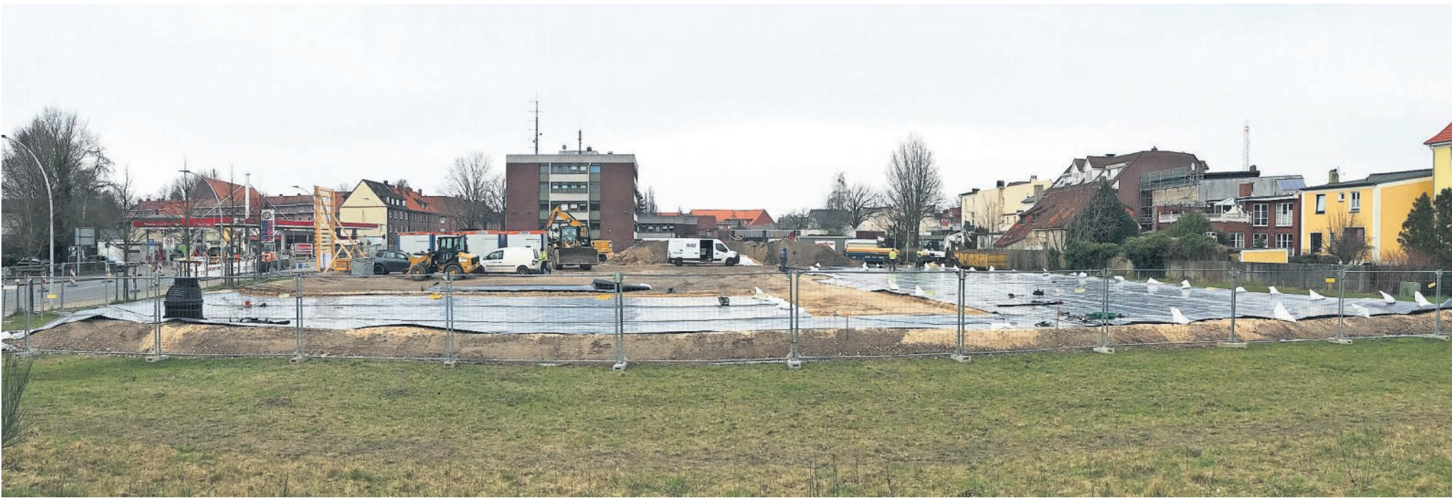
Auf dem Baugelände wurden in dieser Woche große Folien ausgebreitet, die den Aushub aufnehmen sollen. Foto: Reese-Winne
