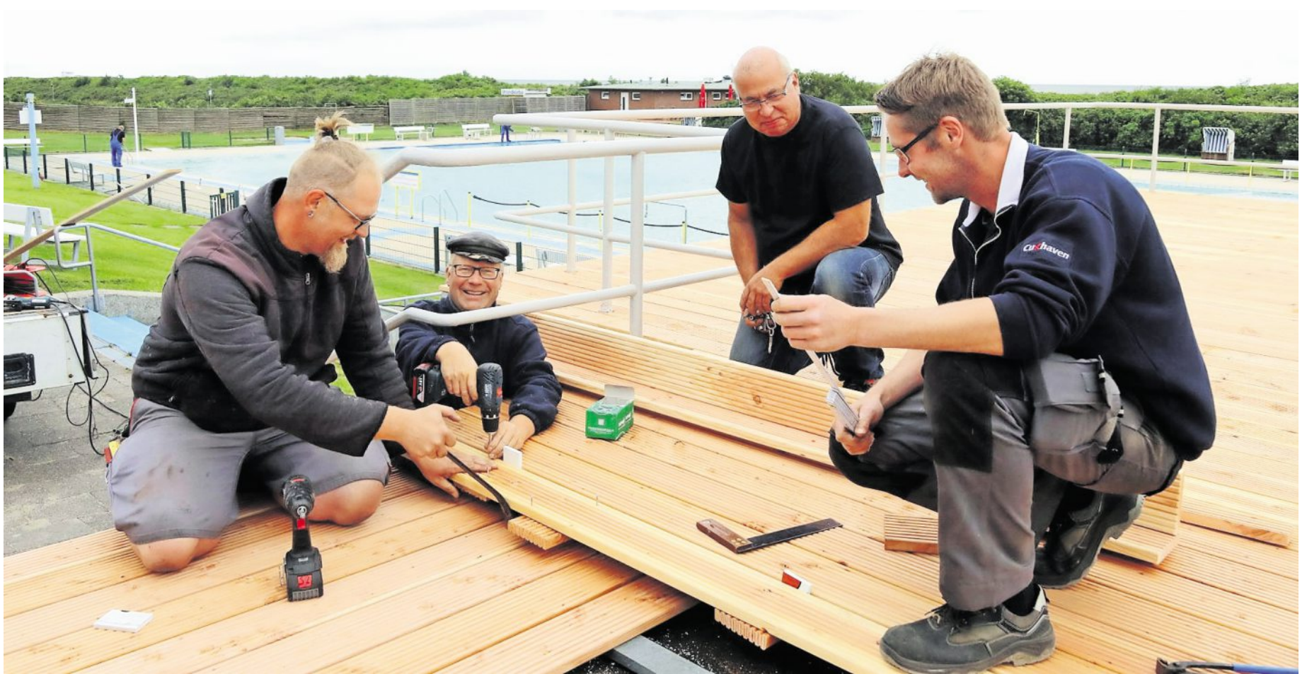
Sanierungsendspurt: Jörg Butt, Dieter Sternhagen, Bädertechnik-Chef Lothar Brechmacher und Vorarbeiter Sönke Binder (v. l. nach r.) befestigen die letzten Holzplanken auf der neu gestalteten Außenterrasse des Meerwasserfreibades Steinmarne. Fotos: Koppe
