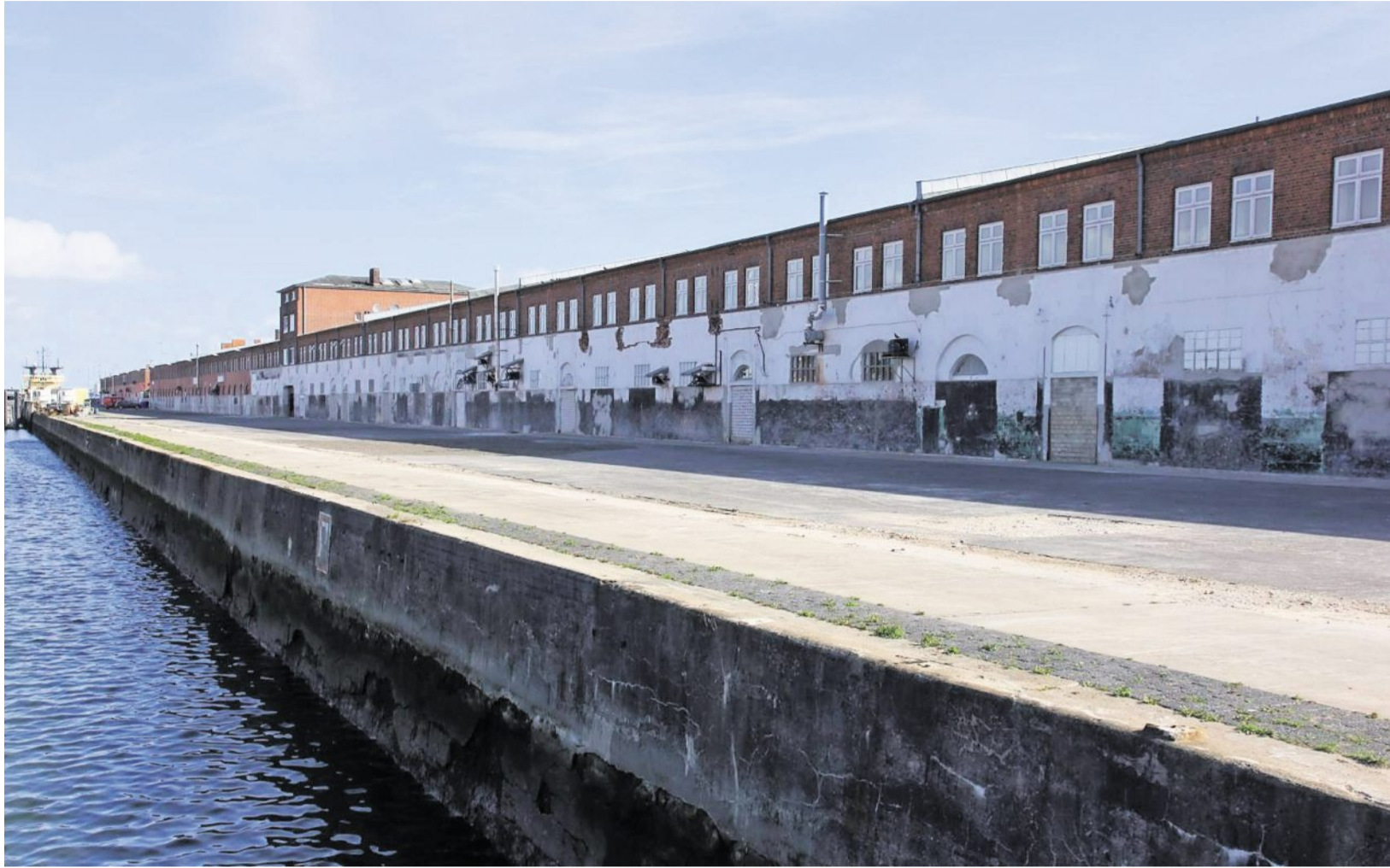
Woher sollen die 30 Millionen Euro für die Sanierung der Kaimauern im Alten Fischereihafen kommen? Die SPD-Fraktion will den Weg mitgehen und eine Gesellschaft unter mehrheitlicher Beteiligung der Stadt gründen, um an Fördermittel zu kommen. Die CDU verweigert sich dem Plan. Foto: Sassen
